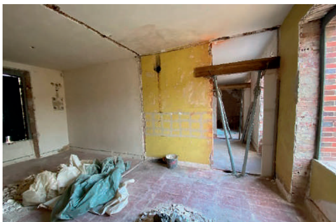
A l'étage, une cloison a été enlevée
