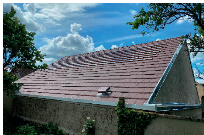
L'intégration des tuiles photovoltaïques est parfaite et quasiment invisible de loin
