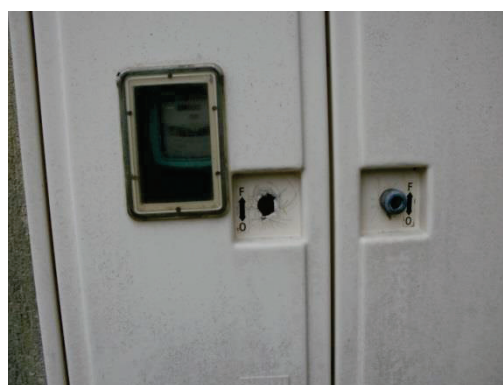
Coffret électrique Dégradé
